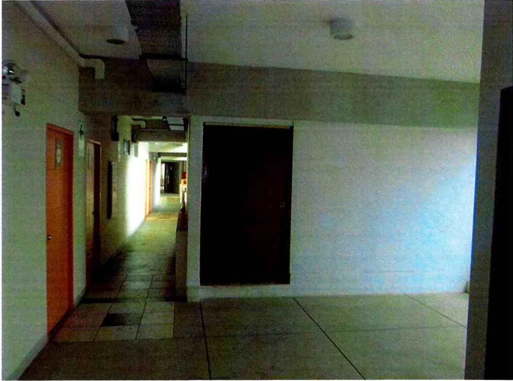
01.- Cuarto de comunicaciones piso siete - Estadio Nacional.
