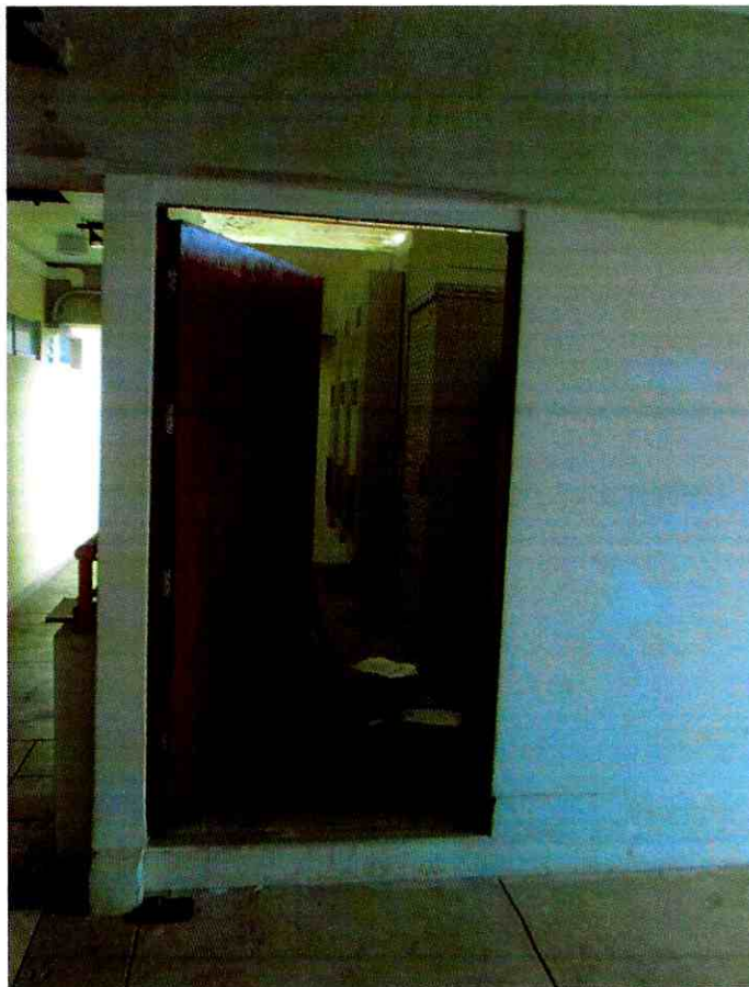
02.- Cuarto de comunicaciones piso siete - Estadio Nacional.
